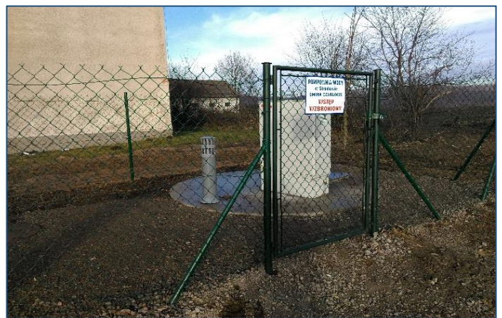
Pompownia wody w Stradowie
